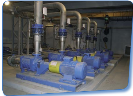
Station de surpression d'eau potable La Rochelle-Mireuil (Charente-Maritime)
